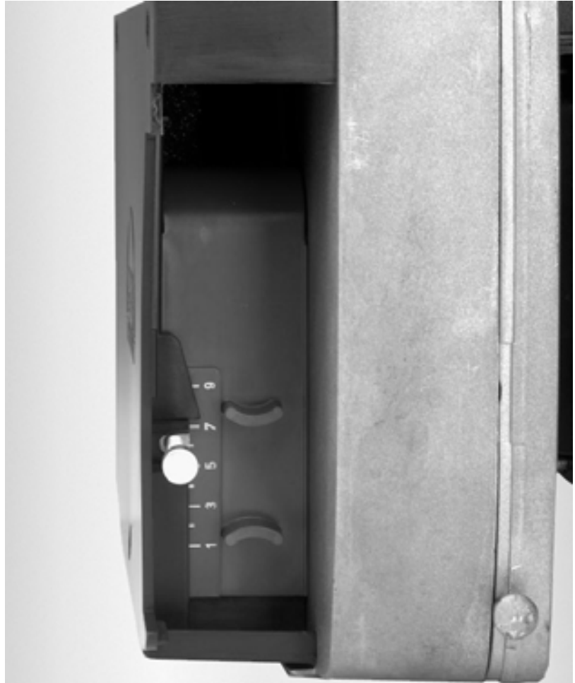
Abb. 12: Luftansaugeschalldämpfer GE 1H sowie Schieber mit Skala und Fixierung
