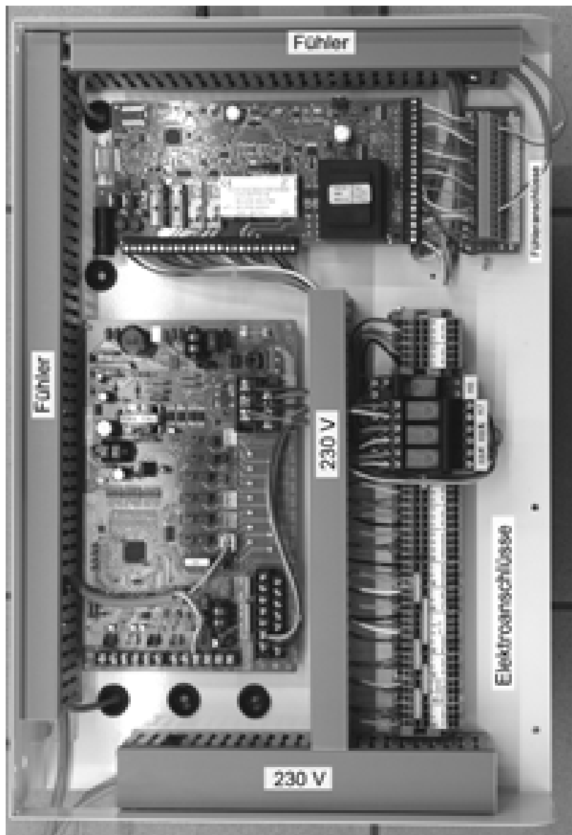
Abb. 32: Elektrik Inneneinheit bivalent bestehend aus Reglerplatten und Klemmleisten sowie Kabelkanäle
