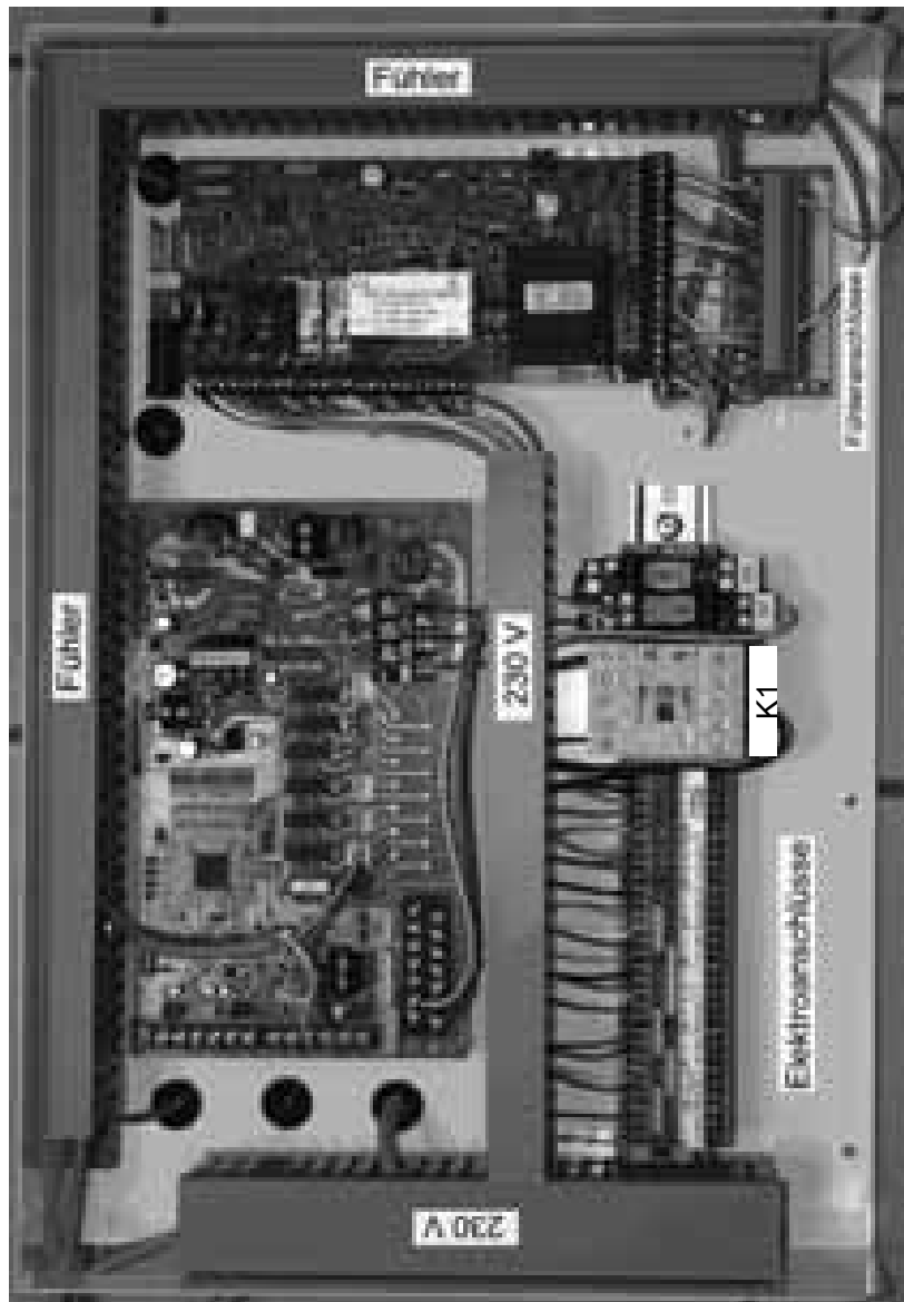
Abb. 35: Elektrik Inneneinheit monoenergetisch bestehend aus Reglerplatinen und Klemmleisten sowie Kabelkanäle
